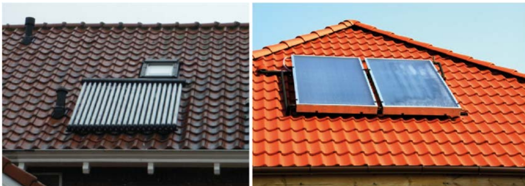
Afb. 14 Zonneboiler met vacuümbuizen (links) en vlakke plaat collectoren (rechts)
