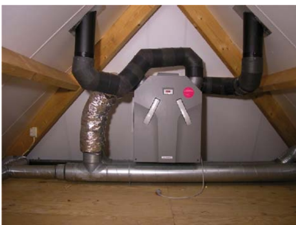
Afb. 13 Ventilatieunit voor mechanische toe- en afvoer van lucht (gebalanceerd ventilatiesysteem)
